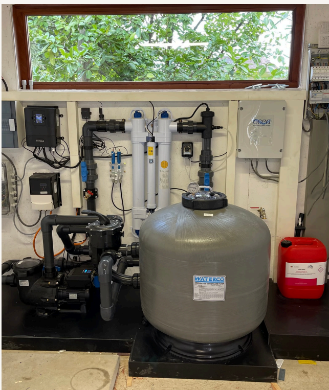
Technische ruimte · project Aartselaar
